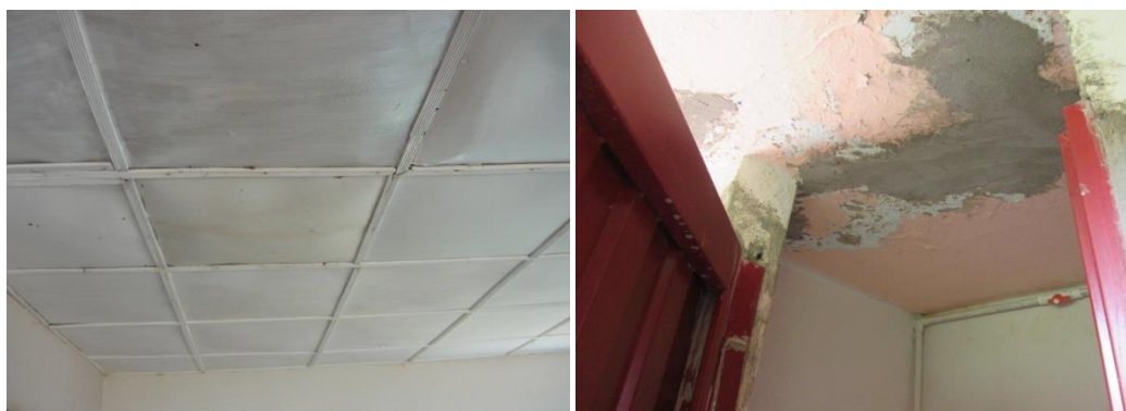
Figura 5. Condiciones de infraestructura de algunos de los establecimientos educativos rurales en municipios cafeteros del suroeste de Antioquia, 2014.
