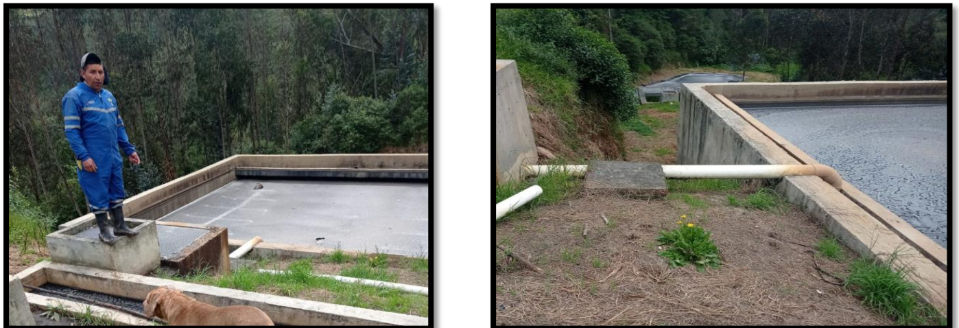
Ilustración 13: Cajilla y tubería que conecta los reactores UASB con los reactores de lodos activados
