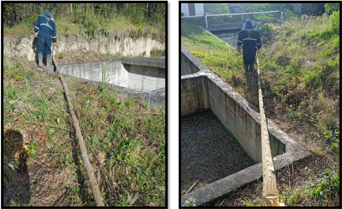
Ilustración 16: Lechos de secado en mantenimiento
