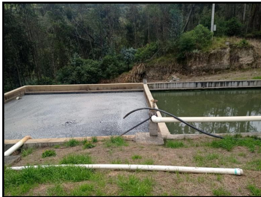
Ilustración 6: Reactor de lodos activados
