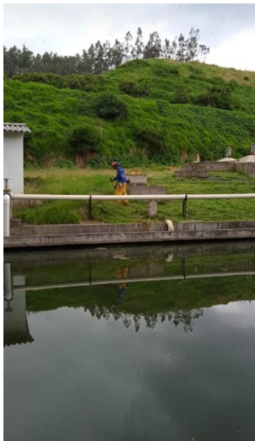
Ilustración 25: Estado actual de los reactores de lodos activados
