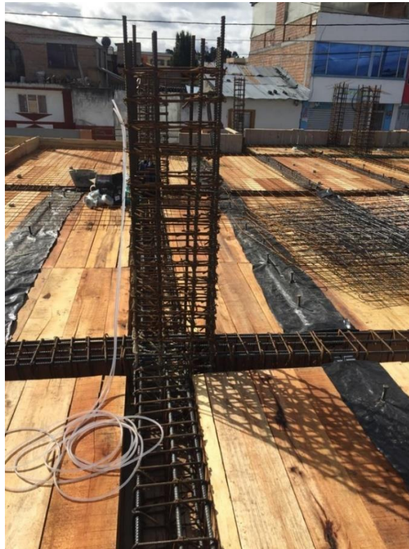
Figura 16. Registro fotográfico, revisión de armado de acero estructural en losa y vigas
