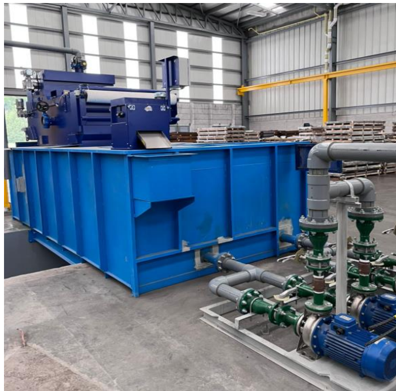
Figura 22. Sistema de filtrado de soluble
