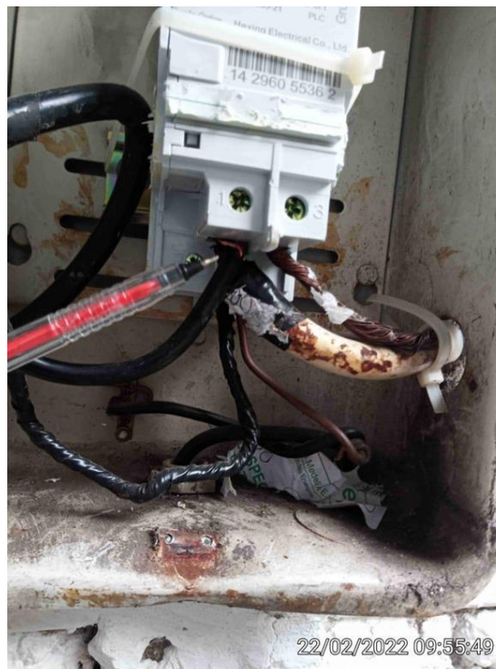
Figura 1. Medidor con línea directa.
