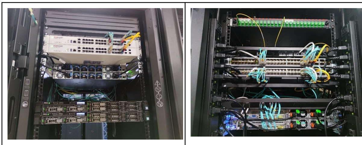
Figura 8. Tablero de imágenes de la instalación de la infraestructura en el datacenter
