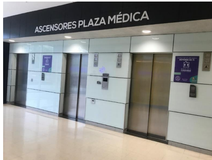
Figura 9. Ascensores de ingreso Plaza Médica
