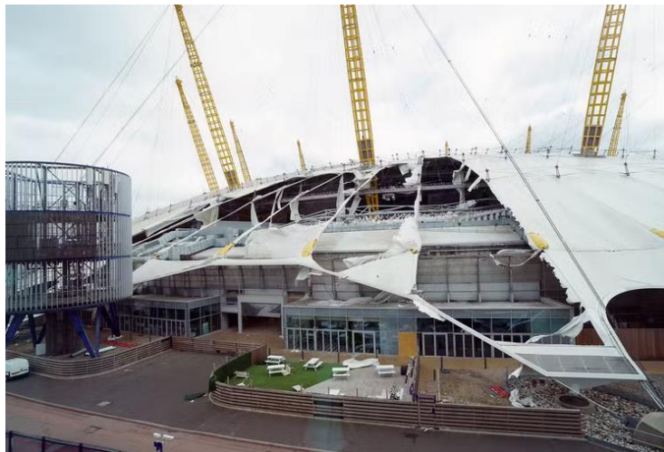
Imagen 16 Daño por viento en la cubierta del estadio London O2 Arena-Londres
