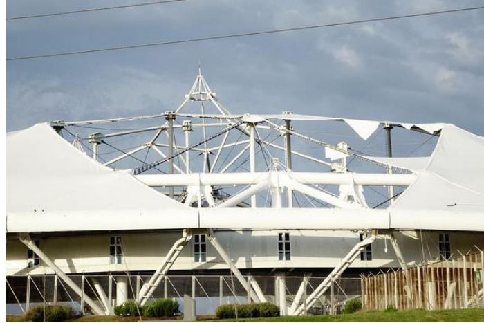
Imagen 15 Daño por viento en la cubierta del estadio único en Argentina.
