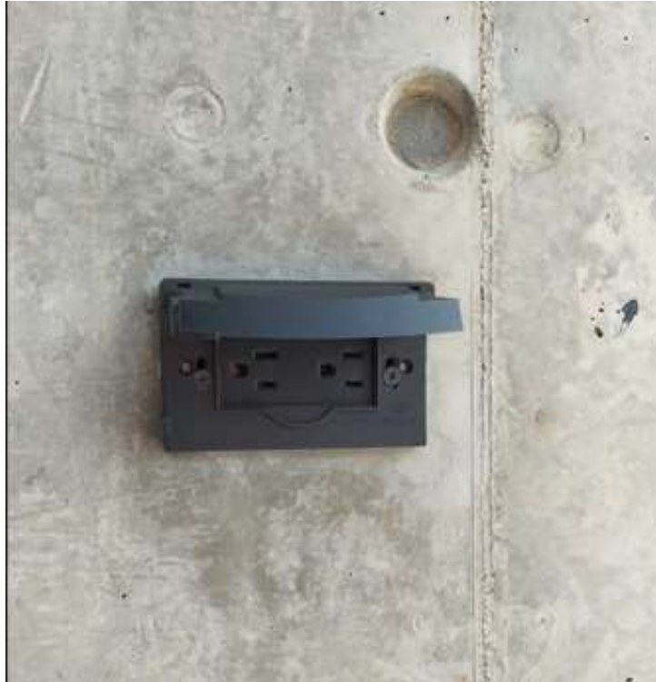
Imagen 6. Tapa intemperie colocada en tomacorriente ubicado en zona expuesta a salpicadura
