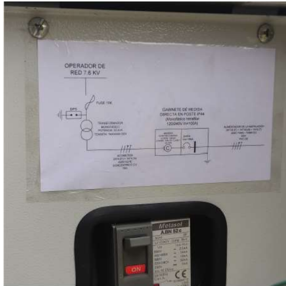
Imagen 7. Diagrama unifilar y directorio de circuitos ubicado en la tapa del gabinete de medida.
