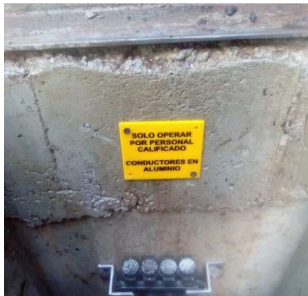
Imagen 8. Conductores de aluminio en cajas de paso para el alimentador del proyecto.
