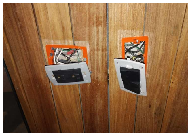
Imagen 5. Suplemento PVC para tomacorriente instalado sobre madera
