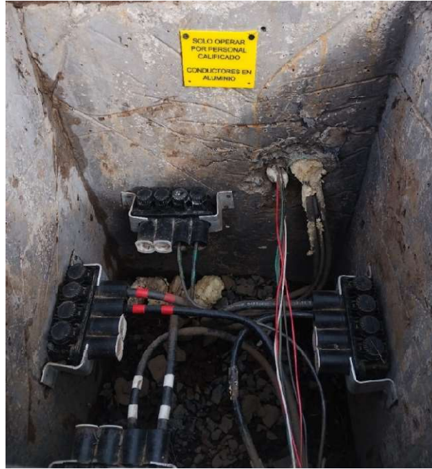
Imagen 2. Identificación de conductores de aluminio en cajas de paso para alimentador.
