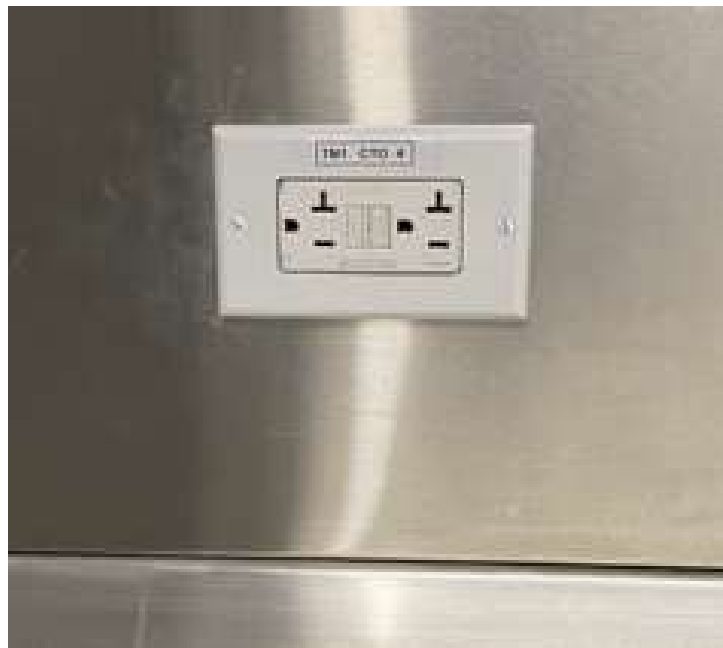
Imagen 9. Tomacorriente sobre meso por uno de tipo GFCI.
