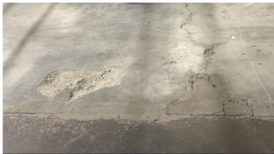
Figura 3: Fotografía del deterioro del piso.
