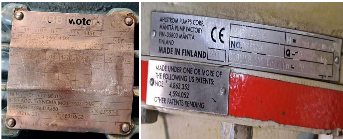
Figura 3. Identificación motor ABB y bomba AHLSTROM.
