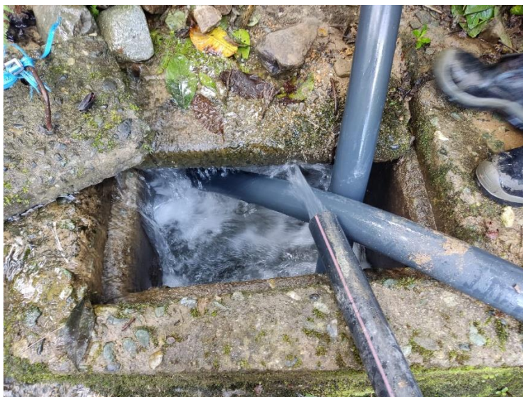
Figura 4. Caja de derivación.
