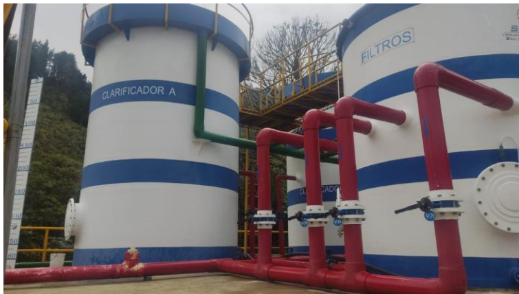
Figura 7. PTAP de filtración rápida Corporación de Acueducto Multiveredal La Acuarela.
