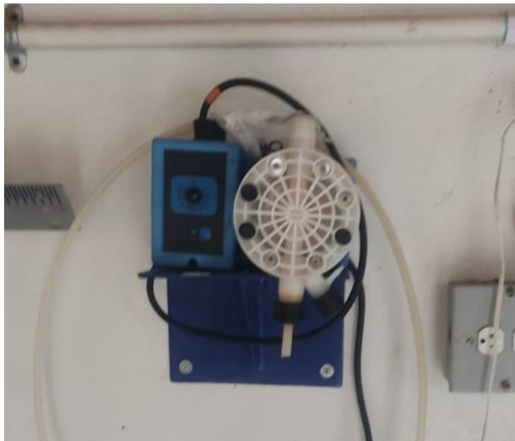
Figura 8. Bomba dosificadora de sulfato de aluminio.
