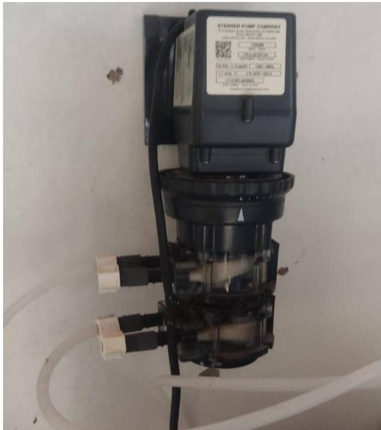
Figura 9. Bomba dosificadora de cal.
