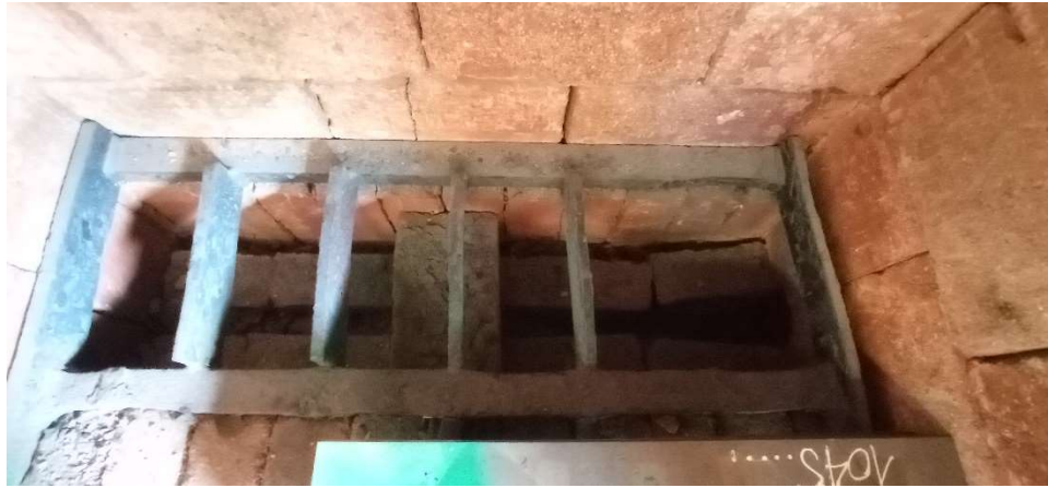
Figura 10. Interior del horno de recocido HR2, ubicación del quemador. Elaboración propia.
