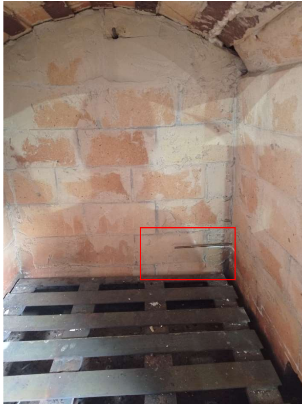
Figura 38. Reubicación de la termocupla. Elaboración propia.
