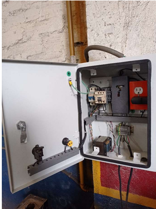
Figura 31. Tablero de control del horno. Elaboración propia.
