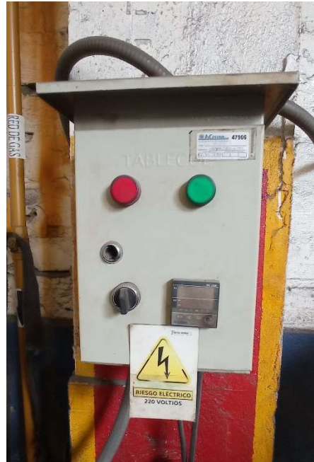
Figura 13. Tablero de conexiones para el control del horno. Elaboración propia.
