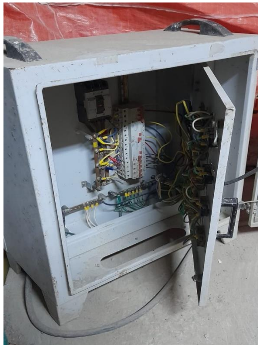
Fig. 5. Tablero móvil abierto y energizado
