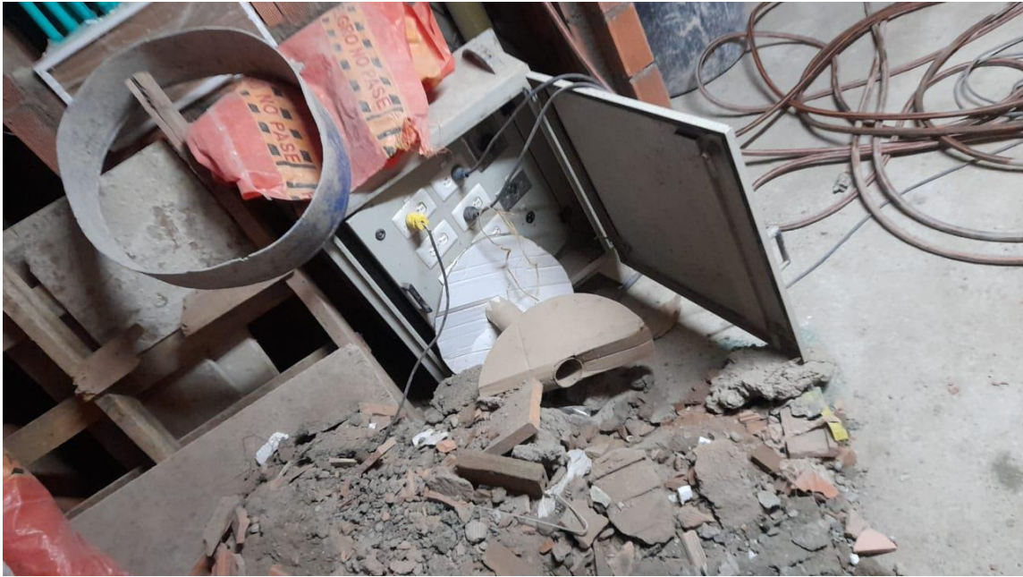
Fig. 4. Tablero móvil bloqueado
