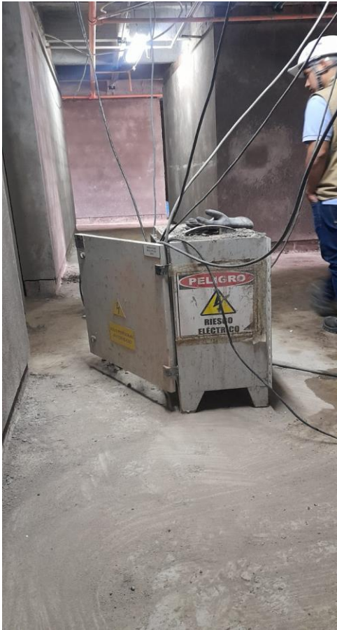
Fig. 6. Tablero en ruta de evacuación Fuente: propia
