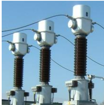
Fig 3. Transformador de tensión.
