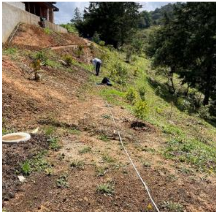
Fig. 11. Medida de resistividad del terreno.
