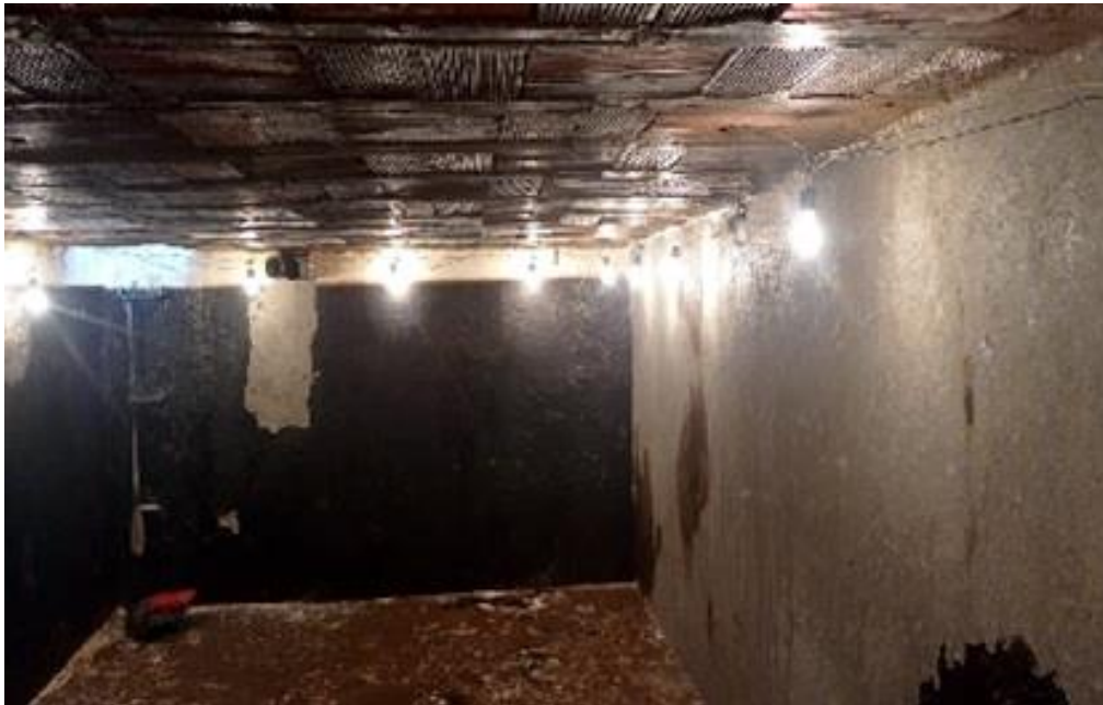
Fig. 1. Paredes del tanque de almacenamiento con desprendimiento del impermeabilizante.
