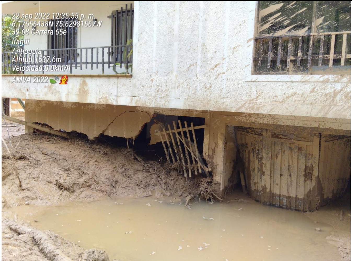
Fotografía 7. Vivienda afectada ubicada en la esquina de carrera 66 con calle 39b
