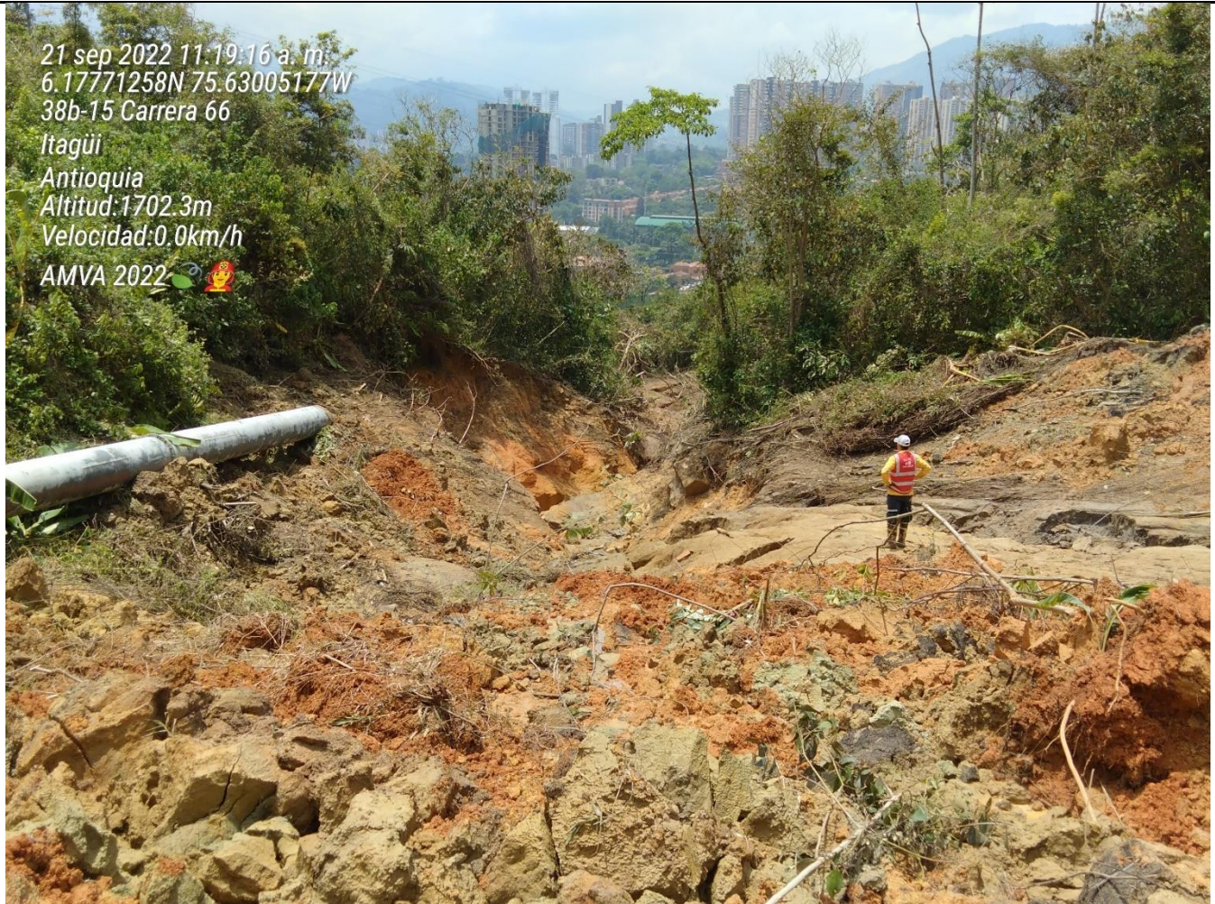
Fotografía 3. Socavación de terreno por saturación de agua y flujo de lodos hiperconcentrado en avenida torrencial..
