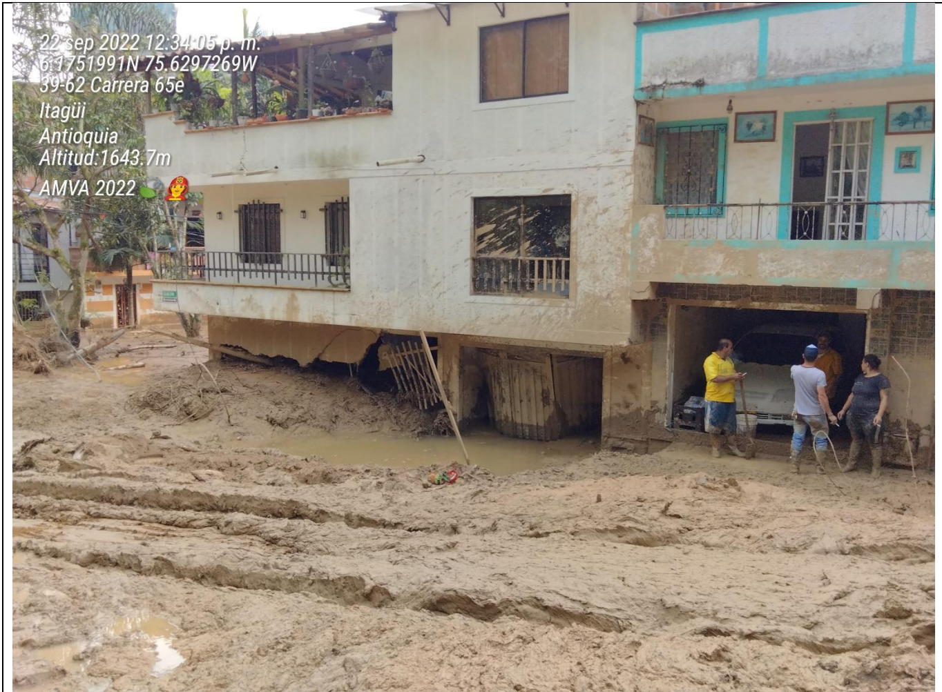
Fotografía 6. Vivienda afectada ubicada en la esquina de carrera 66 con calle 39b
