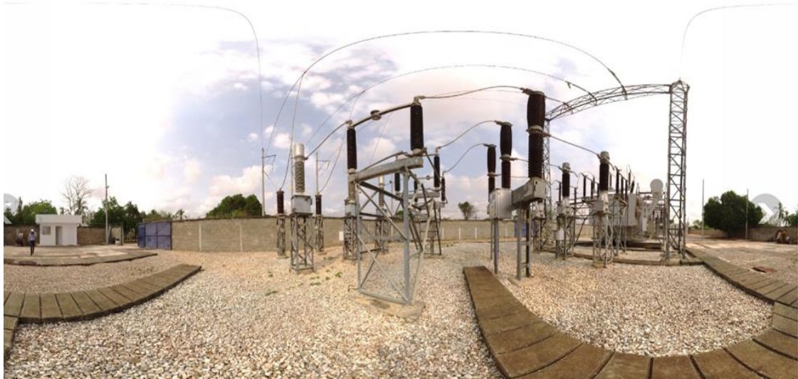
Figura 1. Patio de maniobras subestación Chinú Planta (Fuente propia)
