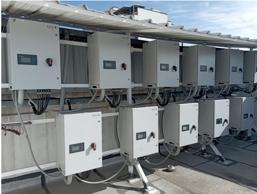
Figura 36. Vista inversores del proyecto.
