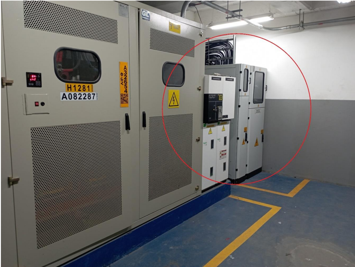
Figura 38. Gabinetes en subestación y protecciones inversores.
