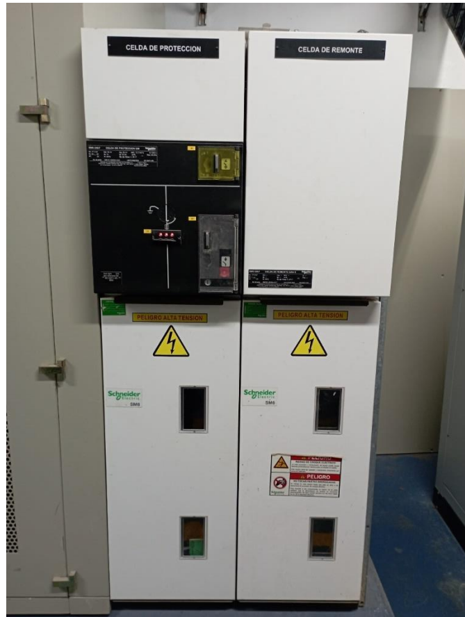
Figura 41. Gabinetes en subestación celdas de protección y remonte.
