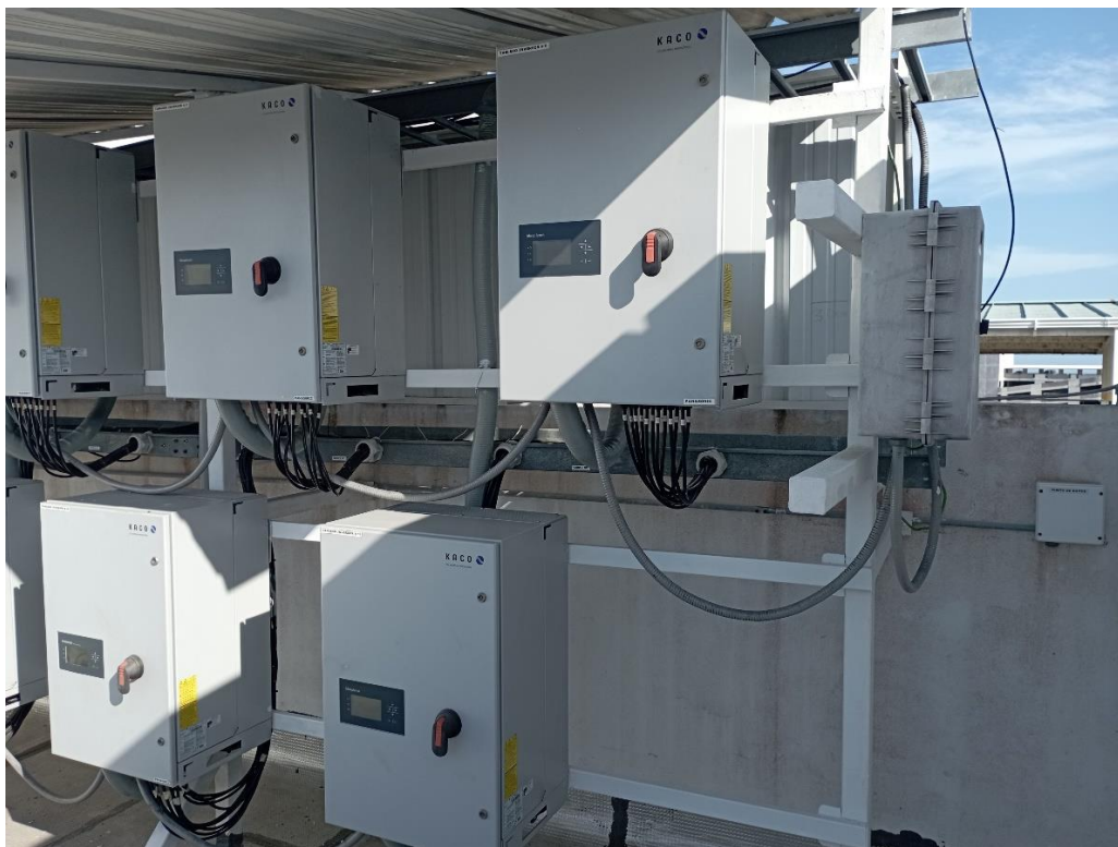
Figura 37. Inversores en detalle.
