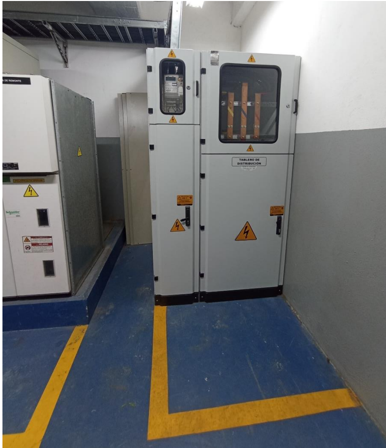
Figura 39. Vista frontal gabinete protecciones inversores y barraje.
