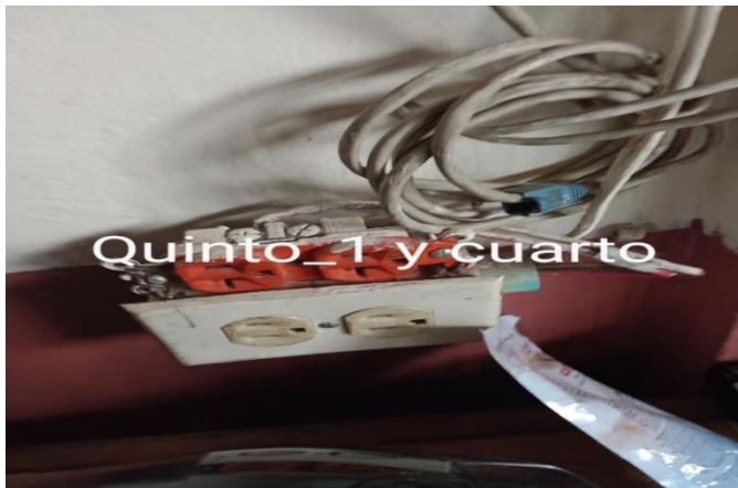
Fig. 54 tomacorrientes en mal estado.
