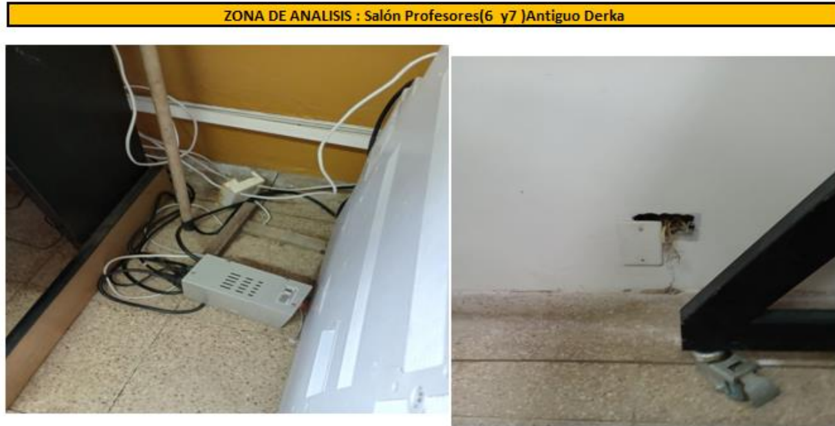
Fig. 33 peligros encontrados en salón de profesores Antigua Antonio Derka.
