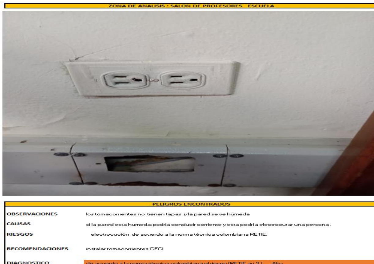
Fig. 33 peligros encontrados en el salón de profesores de la escuela.
