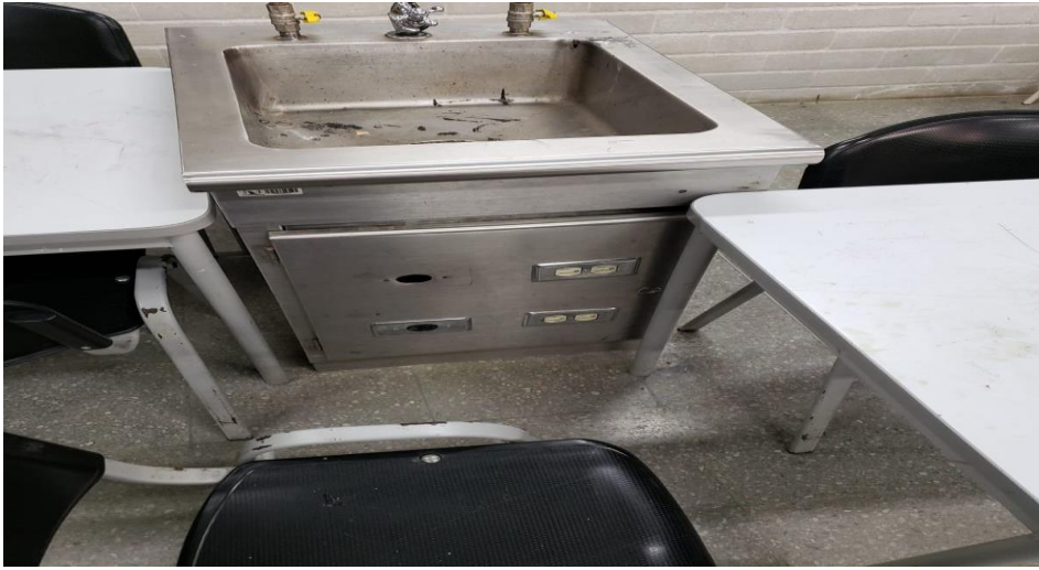
Fig. 55 ausencia de la toma GFCI en el laboratorio.
