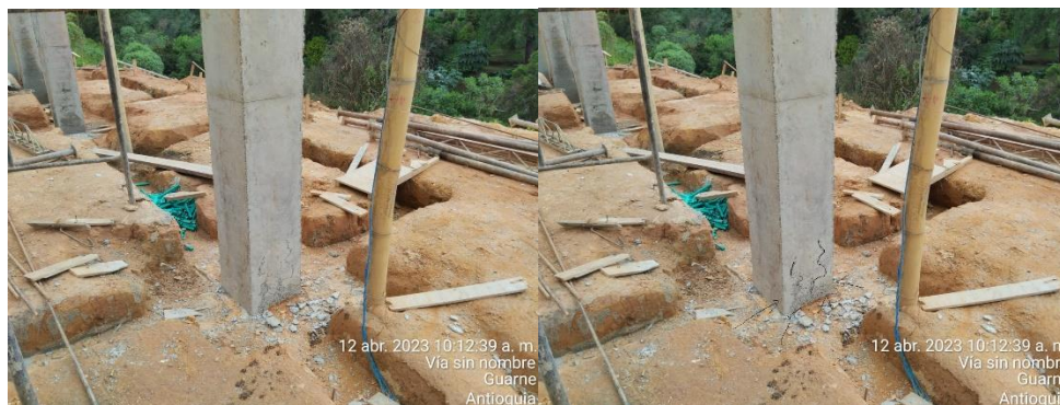
Figura 1. Columna con grietas
