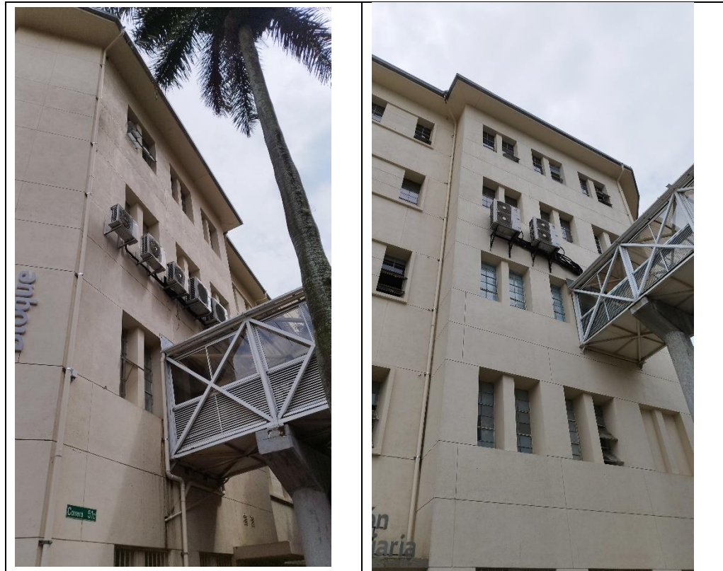
Fig. 8. Ejemplo de equipos que requieren permisos de altura.
