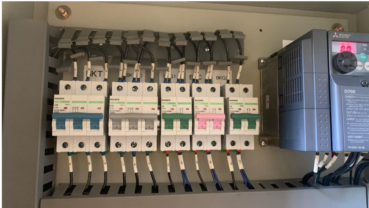
Imagen 36. Sistema de breakers dentro de la caja transformadora del control del horno de recocido HRI.
