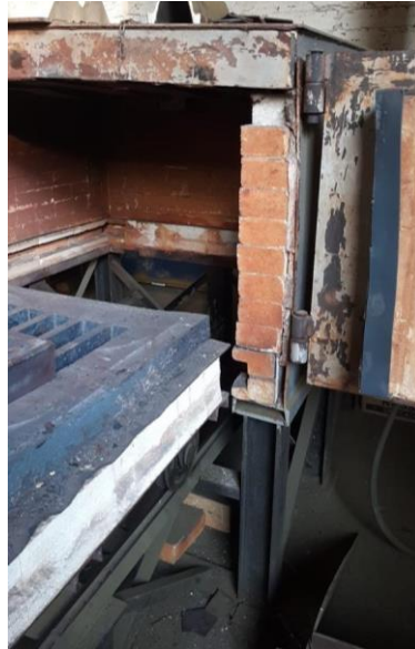
Imagen 5. Foto tomada en diagonal de la puerta, bisagras y estiba metálica.
