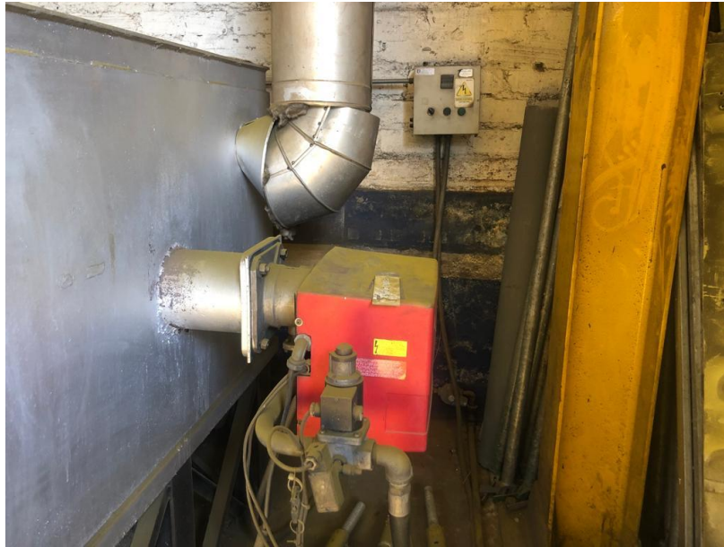
Imagen 3. Quemador y chimenea de horno de recocido HR2 de la empresa Ferrocortes.
