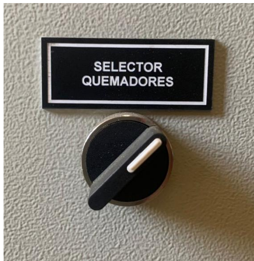
Imagen 22. Llave de paso para encendido de quemadores. Derecha se encuentra abierta.
