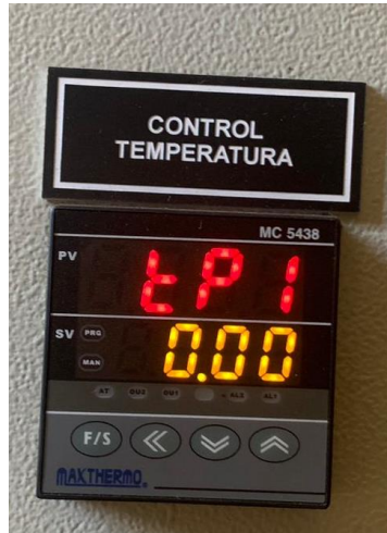
Imagen 34. Tiempo que se demorará en subir por medio de escalas hasta temperatura de control
