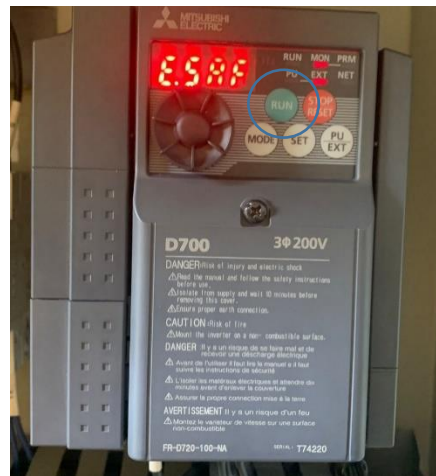
Imagen 25. Variador de velocidad formateado por paro de emergencia.
