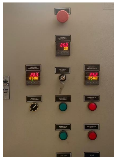
Imagen 18. Tablero de control automático.
