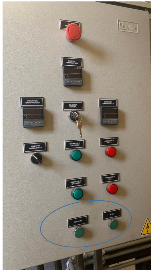
Imagen 37. Caja de control con el posicionamiento de botón para movimiento de cadena.
