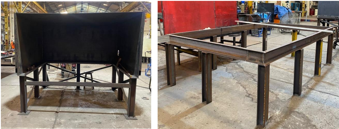
Imagen 14. a) Marcación para corte de material y biselado. b) Armado de estructura del horno.
