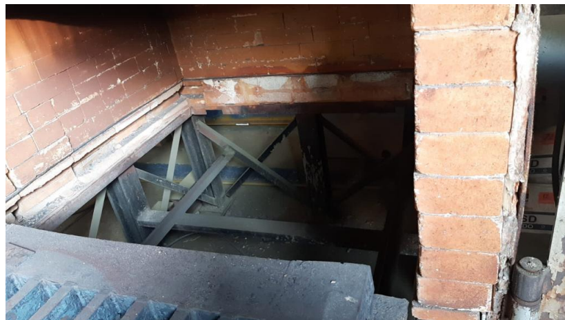
Imagen 2. Desviación de estructura en ladrillos del horno de recocido actual de la empresa.
