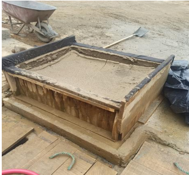
Caja de limpieza de lodos con filtro de agua
