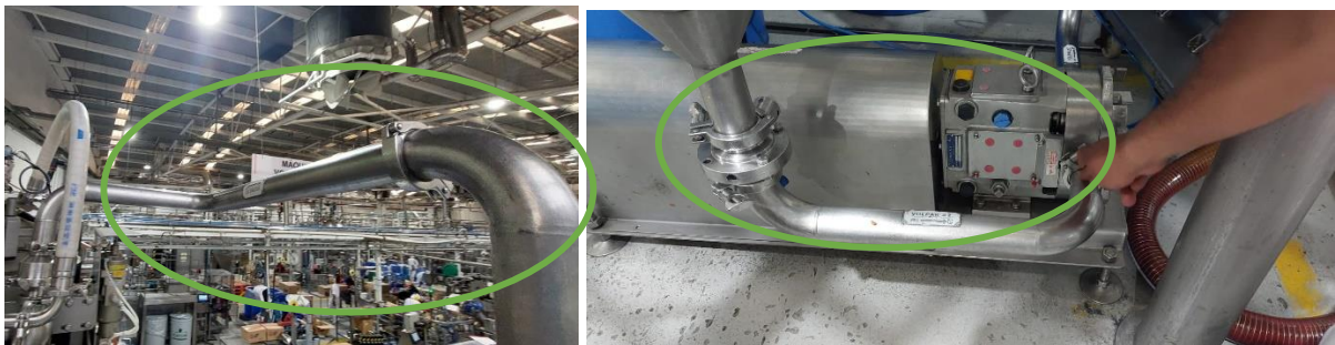
Figura 19 Tubería con curvatura
