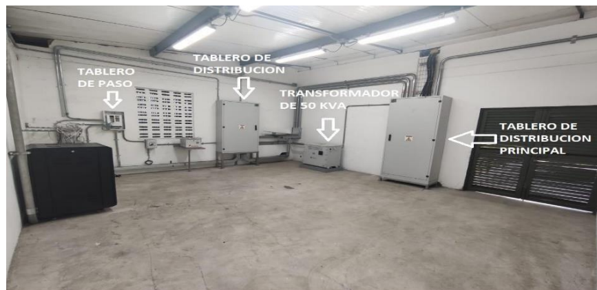
Fig. 1. Cuarto eléctrico subestación la caldera
