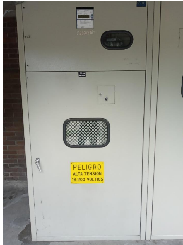
Figura 3. Celda de medida en media tensión.
