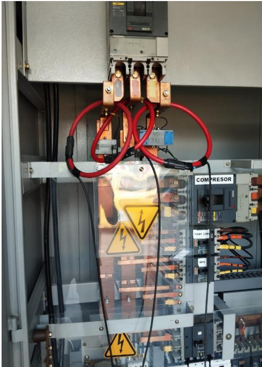
Figura 19. Montaje en sitio del analizador de redes.
