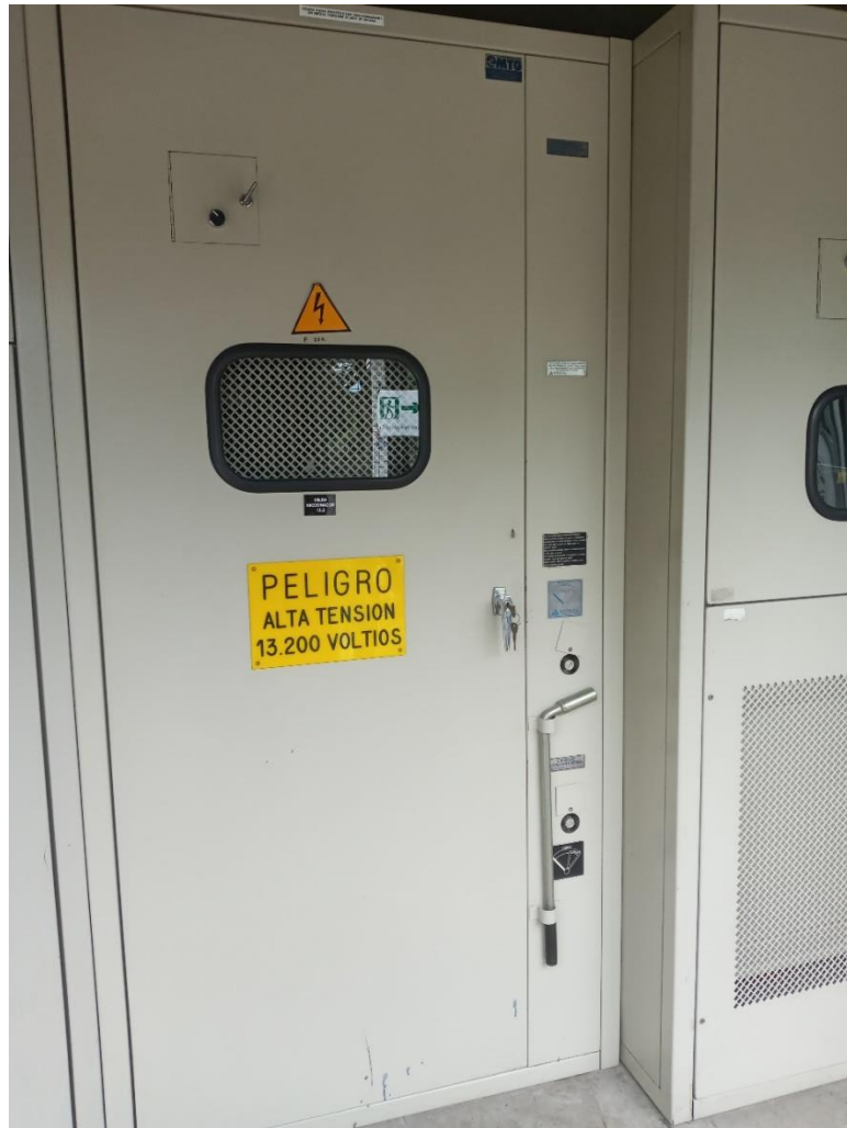
Figura 4. Celda del seccionador.
