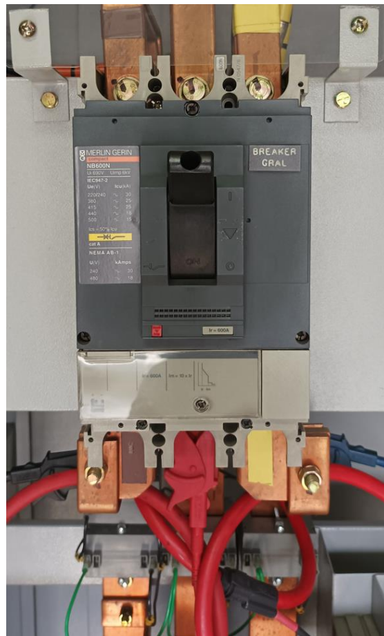
Figura 20. Protección general trifásica de 3x600A.
