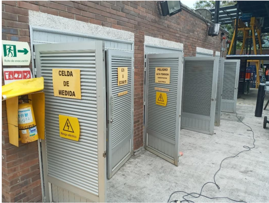
Figura 2. Subestación eléctrica Tasajera 1.
