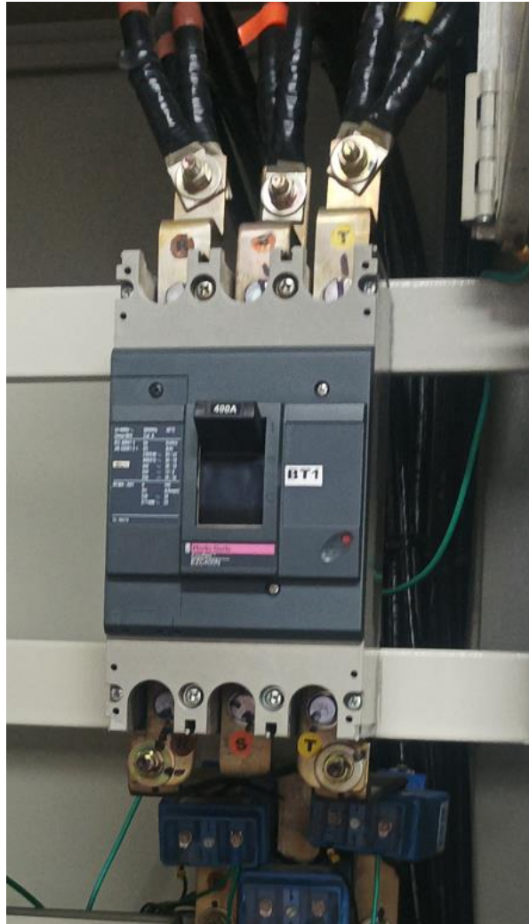
Figura 7. Protección general de la subestación 3x400A.
