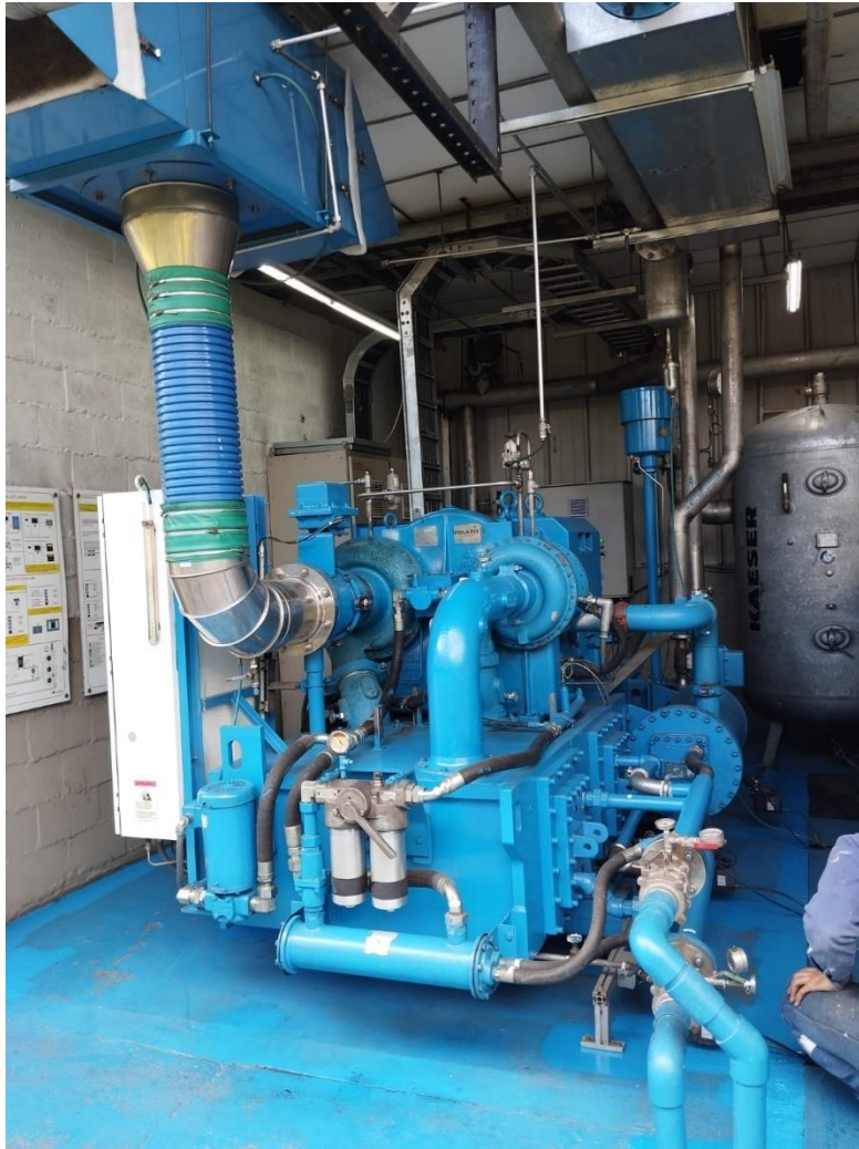
Fig. 7. Compresor de 500 HP
