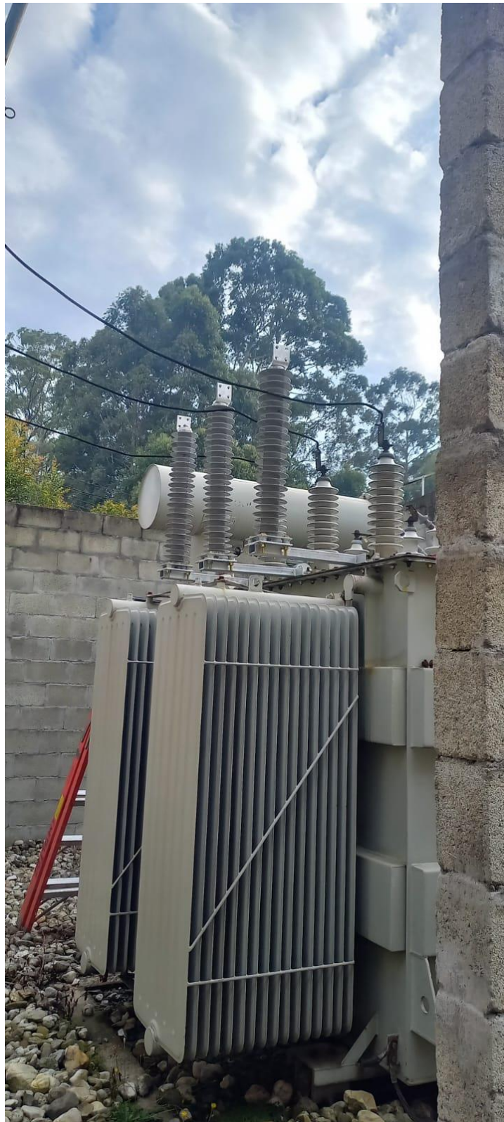
Fig. 14. Nuevos DPS en los transformadores principales
