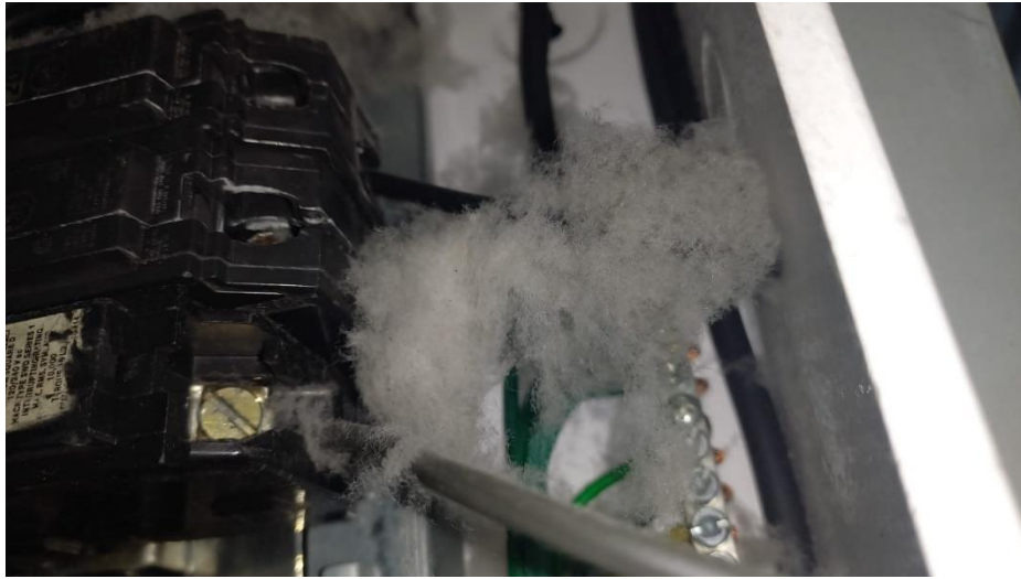
Fig. 25. Aspectos por mejorar en el sistema eléctrico
