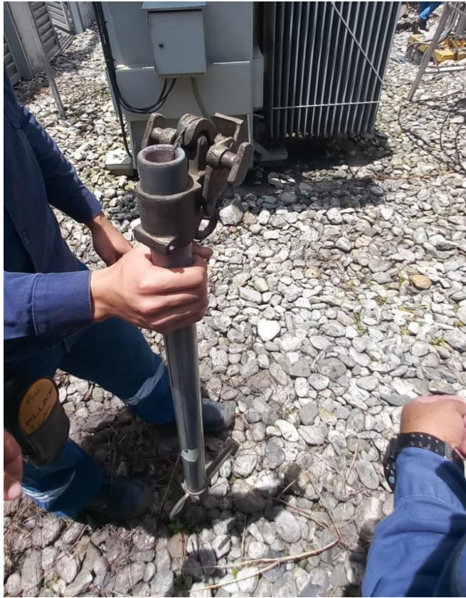
Fig. 13. Fusible con puntos calientes
