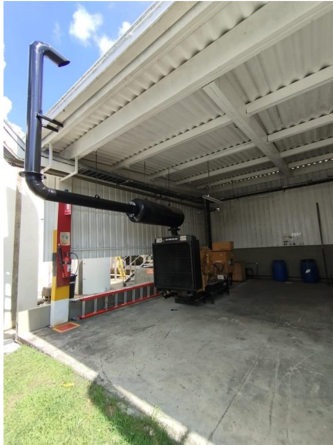
Fig. 4. Planta de emergencia ubicada en una sección diferente
