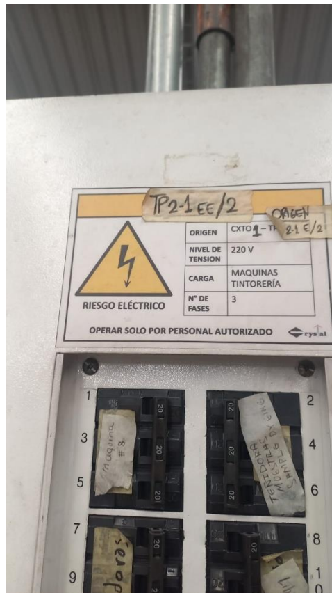
Fig. 8. Tablero de distribución con mala marcación
