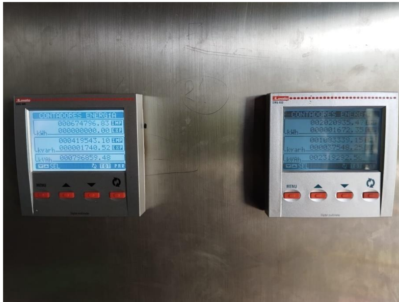
Fig. 22. Analizadores de redes en subestaciones y gabinetes
