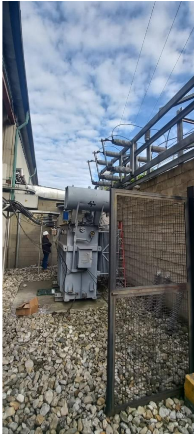
Fig. 6. Transformador principal 44 kV/440 V
