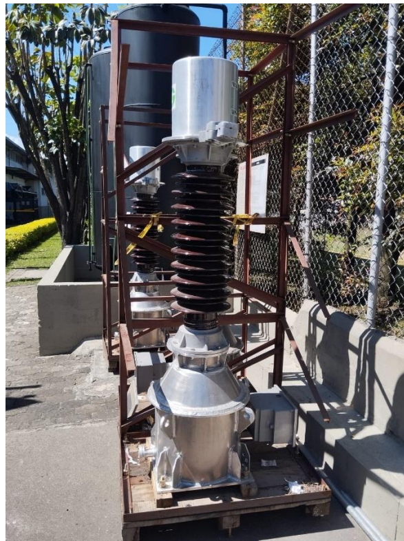
Fig. 17. TP de 52 kV instalado en pórtico
