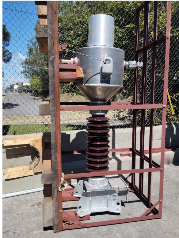
Fig. 16. TC de 52 kV instalado en pórtico
