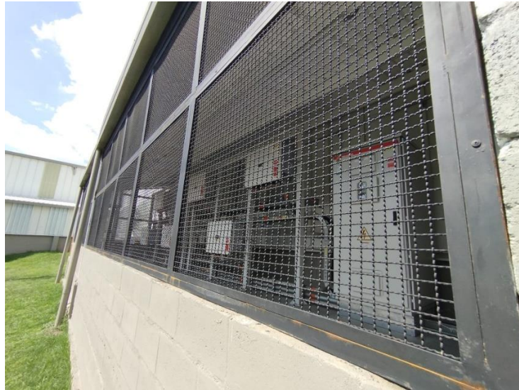
Fig. 5. Cuarto de inversores
