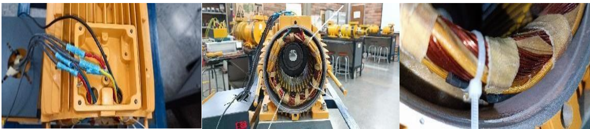
Figura 33: Instalación del sensor de temperatura en el devanado del estator.
