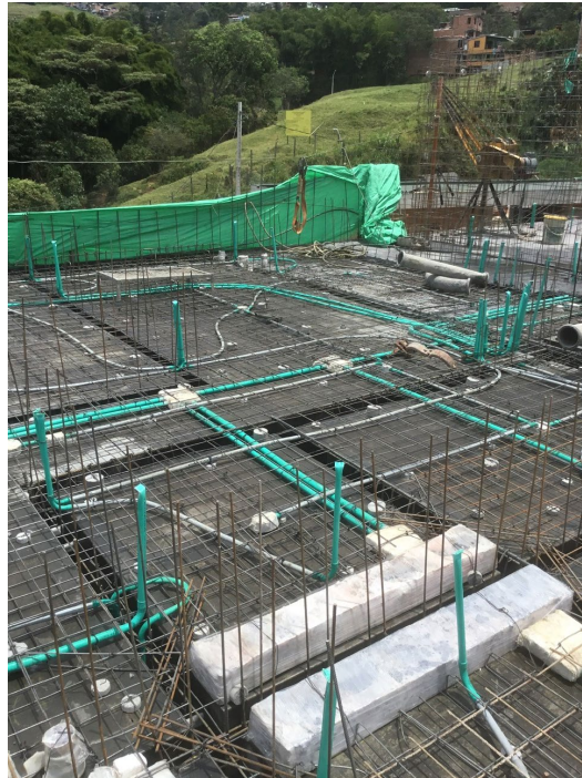
Figura 7. Losa del proyecto Villa Gabriela con línea de vida y protección anti caída al exterior (Elaboración propia).
