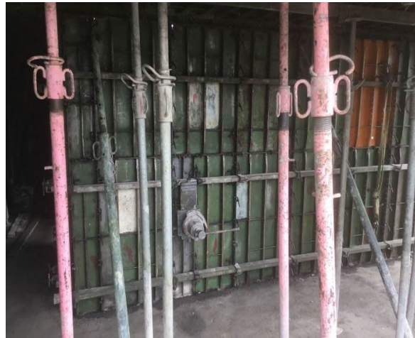
Figura 19. Tobera en formaleta para la ejecución de vaciado flujo inverso (Elaboración propia).
