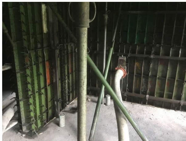
Figura 20. Instalación de manguera en tobera para la realización de vaciado flujo inverso (Elaboración propia).
