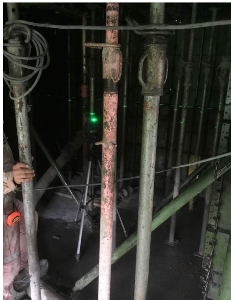
Figura 12. Nivel laser en parte inferior de losa para revisión de horizontalidad en la obra Villa Gabriela (Elaboración propia).
