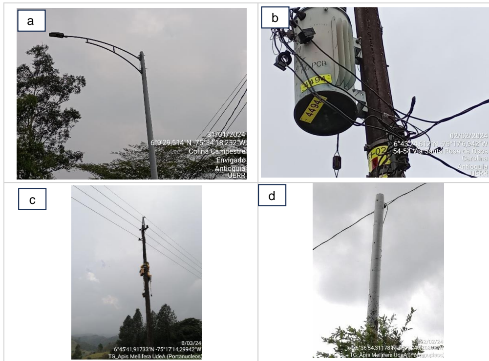
Imagen 1. A. Poste de fibra con luminaria. B. Poste de concreto con transformador. C. Poste de concreto, línea primaria. D. Poste de fibra línea secundaria.
