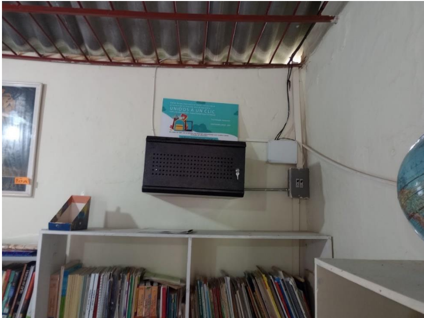
Foto 1 Gabinete que contiene los equipos de los CER.
