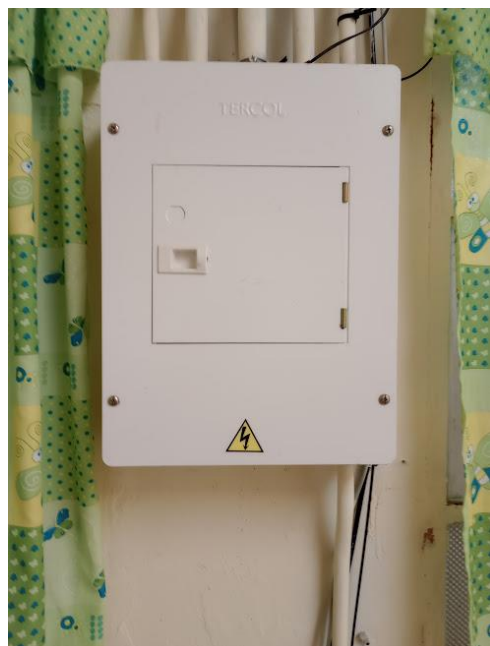
Foto 26 Caja de breakers conexión eléctrica
