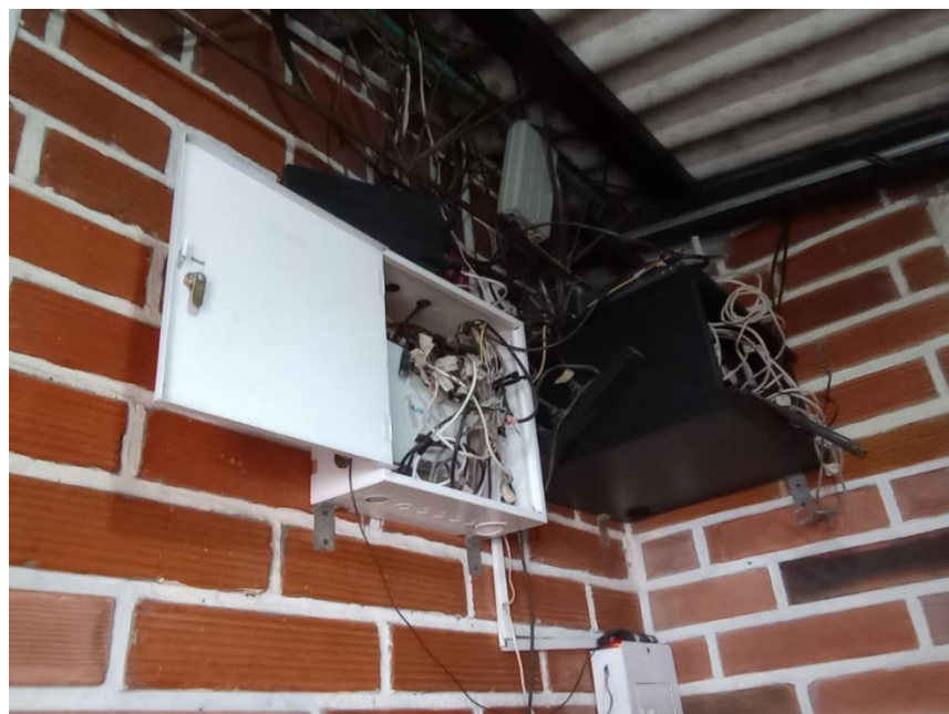
Foto 15 Punto de conexión de fibra óptica de la ISP prestadora del servicio
