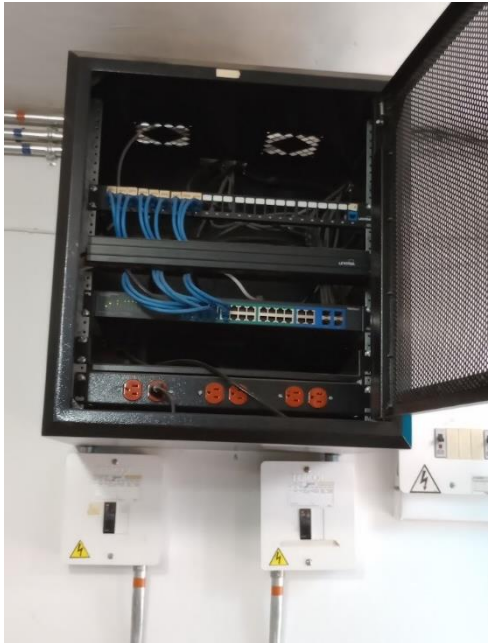
Foto 13 Rack de telecomunicaciones IE
