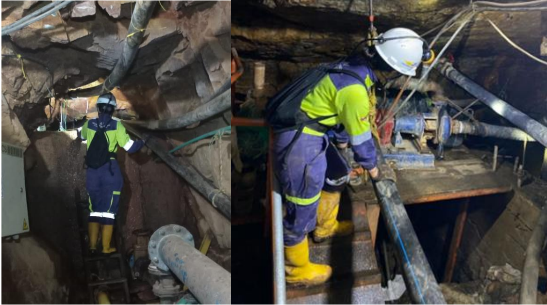
Figura 37. Registro fotográfico - Reconocimiento sistema de tratamiento de ARnD mina El Silencio.
