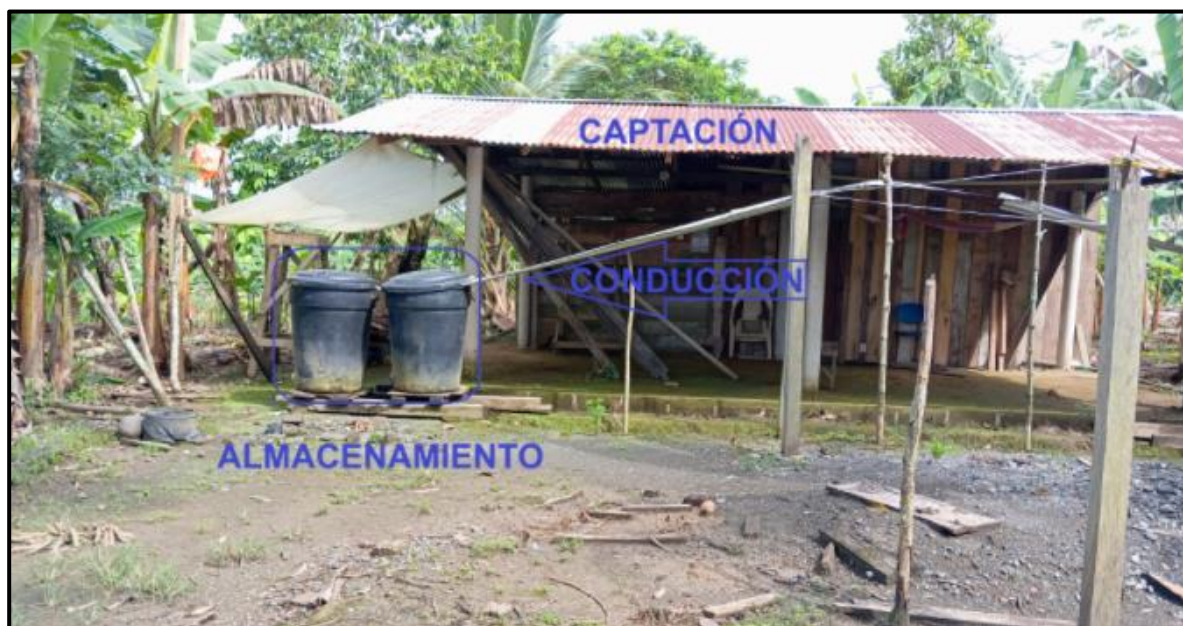
Fotografía 2. Sistema de captación aguas lluvias
