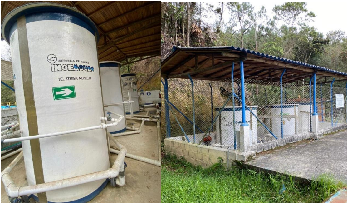
Figura 11 Zona de filtración de la PTAP
