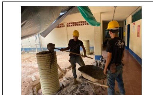
FOTO 4 Concreto de 21 Mpa para Pedestales . incluye mano de obra, vibrado, formateas. No incluye refuerzo. Según diseño.
