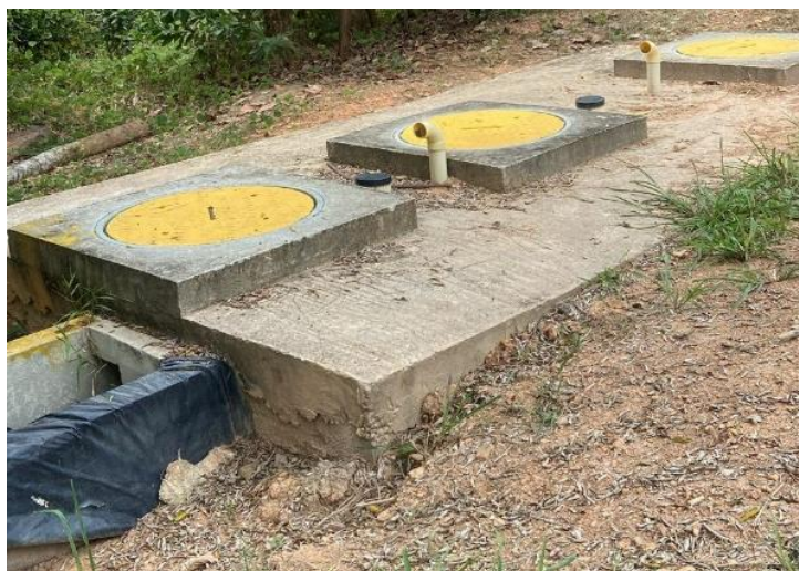
Sistema séptico Mina Las Palmeras
