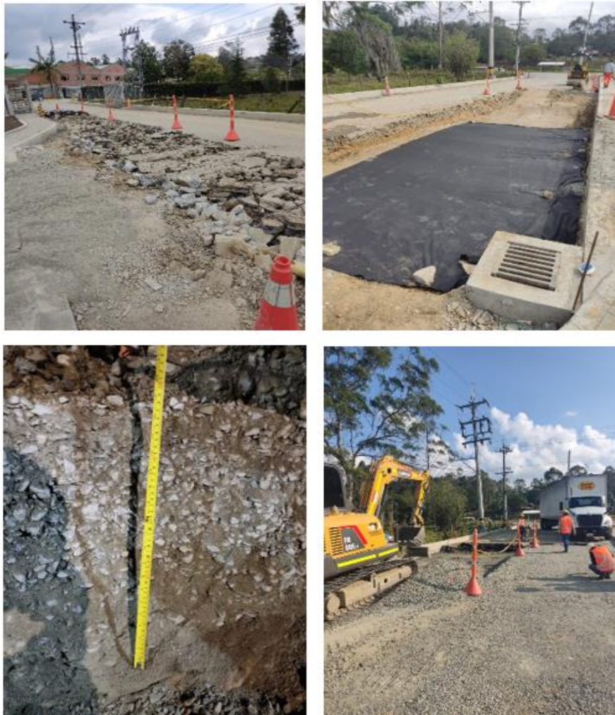
Figura 12. Verificación de espesor de base y profundidad de excavación. Fuente: elaboración propia.
