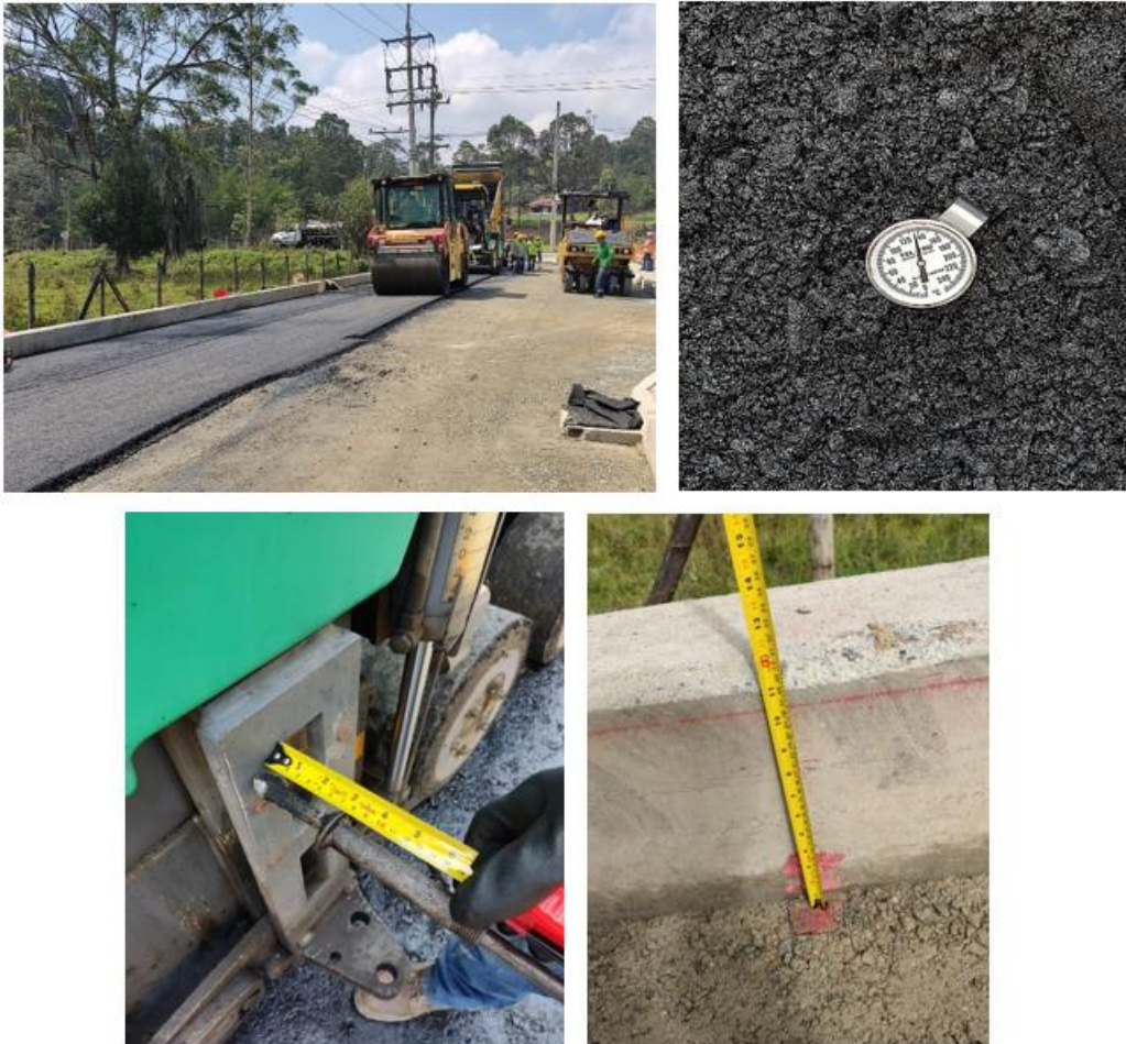
Figura 13. Verificación de espesores y temperatura de mezcla asfáltica para pavimentación. Fuente: elaboración propia.
