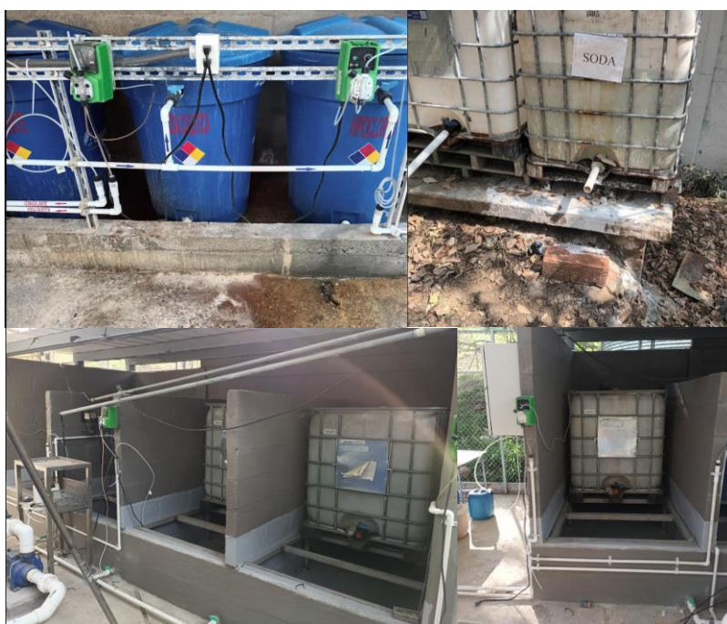
Figura 16. Diques de contención inadecuados e inexistentes con derrames al suelo (imagen superior) y diques construidos con normativa, compatibilidad y eliminando el riesgo de derrame a suelo (imagen inferior) en la planta carnes frías en Copacabana.
