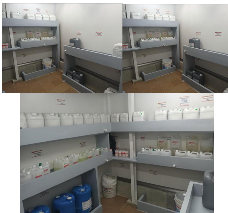
Figura 15. Cuarto de almacenamiento de sustancias químicas de aseo y desinfección-Calidad con compatibilidad, diques de contención y estanterías construidas.
