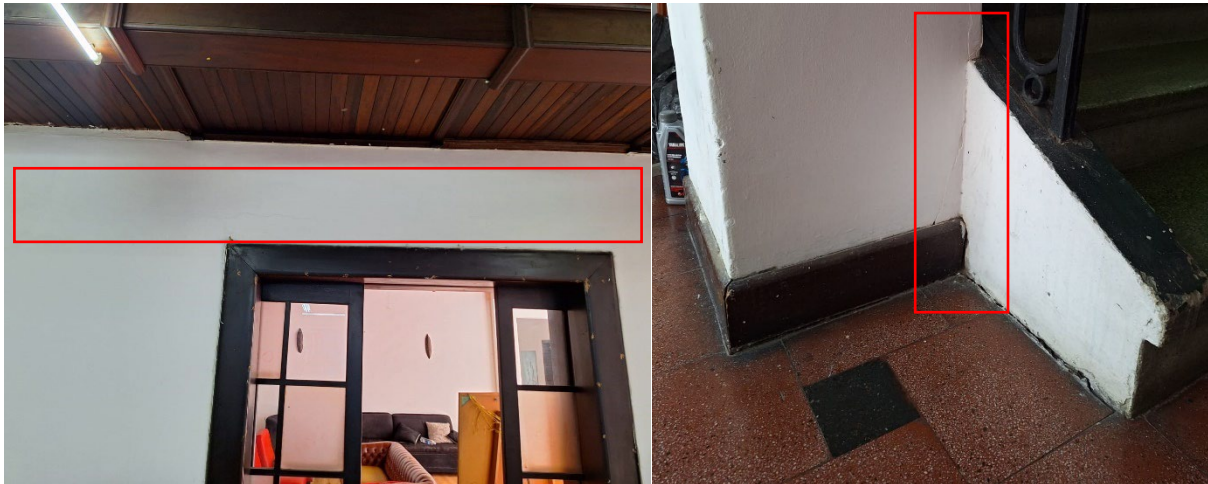
Figura 14. Fisuración horizontal en muro y en columna primer nivel. Elaborado por los autores, 2024.
