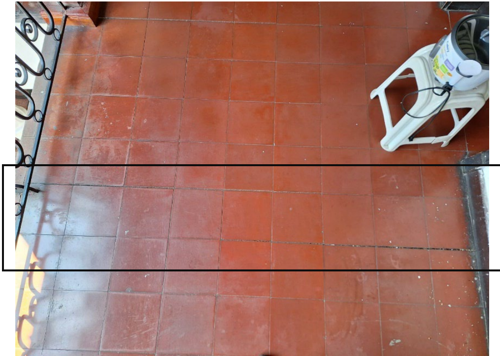
Figura 16. Fisuración en losa de entepiso del segundo nivel. . Elaborado por los autores 2024
