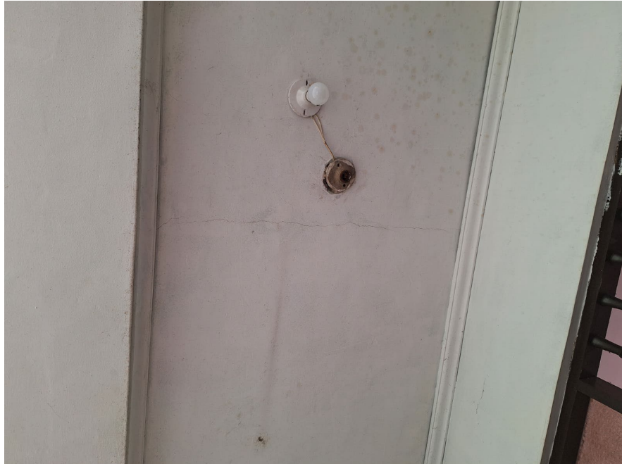
Figura 17. Fisuración en losa de entepiso del segundo nivel. . Elaborado por los autores 2024
