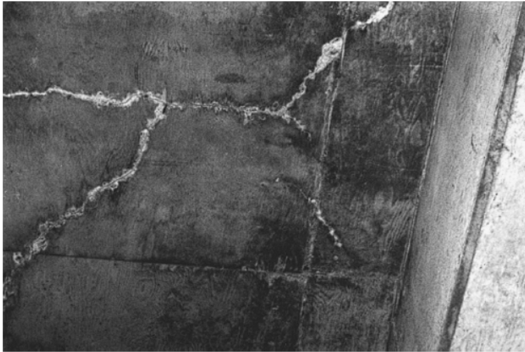
Figura 4 Grietas aleatorias con eflorescencia en la parte inferior de una losa elevada. Tomada de : Reparación de grietas”. Cap. 5.2 en Renovación estructural de edificios: métodos, detalles y ejemplos de diseño
