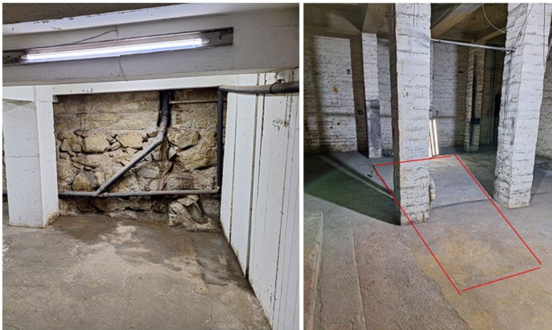
Figura 12. Humedad en muros y zona de afectación por daño en acometida. Elaborada por autores, 2024.
