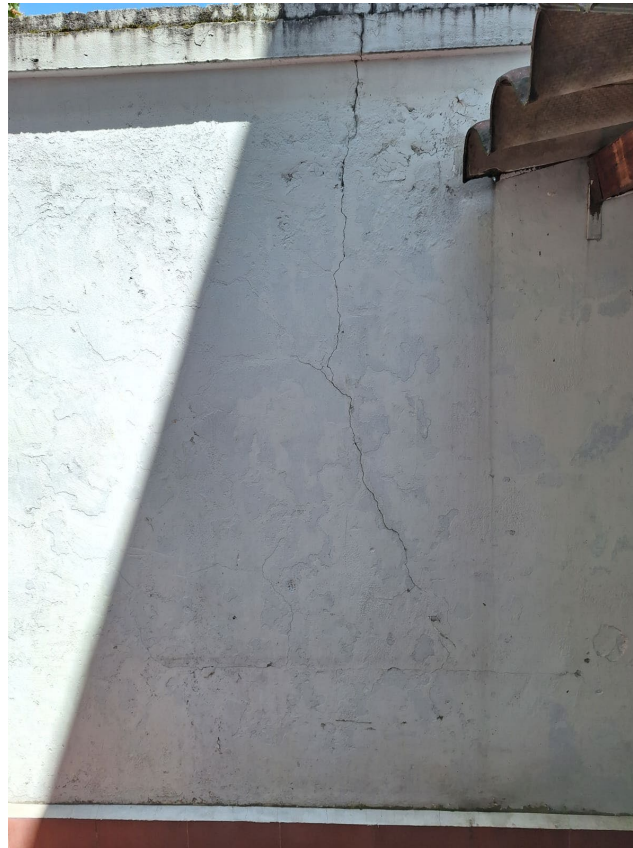
Figura 18. Fisuración en muro de patio del primer nivel. . Elaborado por los autores 2024
