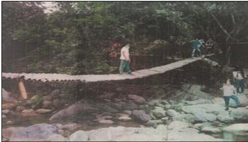
Imagen 1. Estado del puente en cuestión. Municipio de Ibagué
