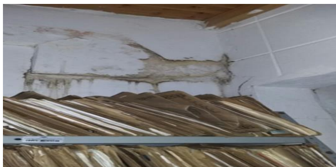
Fotografía n° 7. Archivo clínico, humedad (Caucasia Antioquia 2017)
