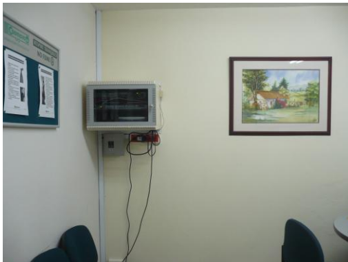
Cables conductores de energía
