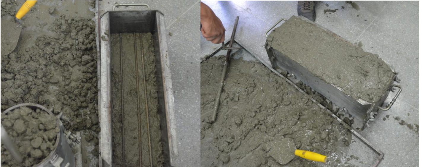
Figura 18. Armado de los cilindros y vigas con colocación de su respectivo acero (Fuente propia).
