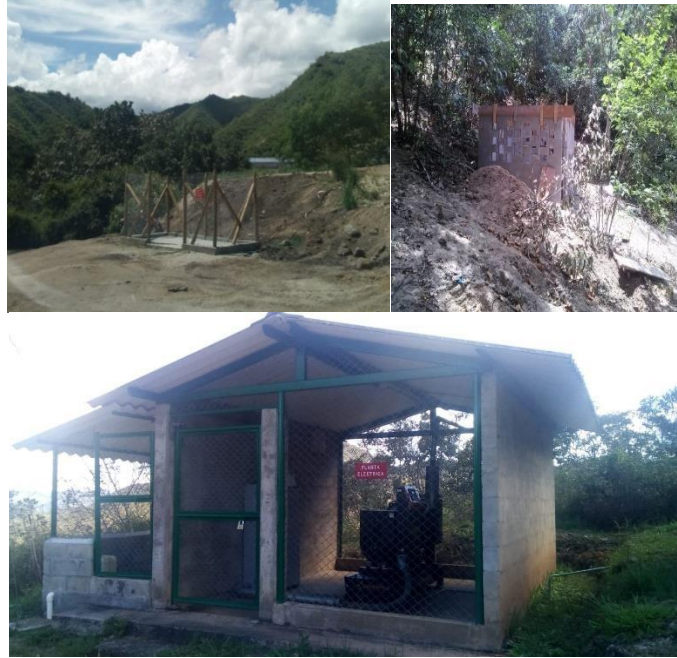
Foto 12. Caseta de residuos, bombeo de porcinaza y eléctrica.
