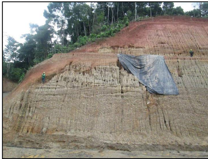
Imagen 1. Taludes con problemas de erosión en surcos y cárcavas, modelados en una secuencia estratigráfica de areniscas y conglomerados. Vía Ruta del Sol.
