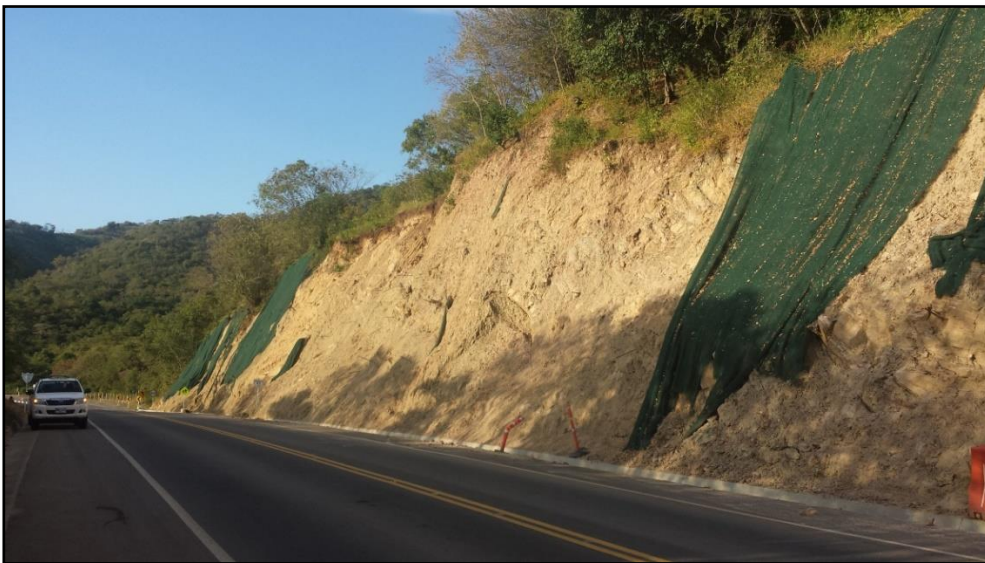
Imagen 8. Desprendimiento de geo sintéticos. Vía Honda- Girardot. Fuente: Propia
