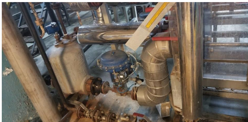
Figura 11. Montaje en serie de bomba y trampa de vapor.
