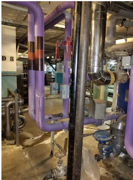
Figura 8. Tubería (morada) de recirculación de soda sin aislamiento.
