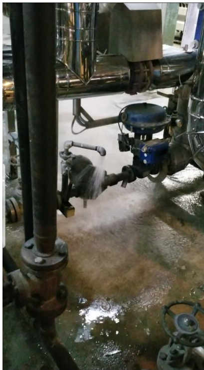
Figura 10. Desperdicio de condensados.
