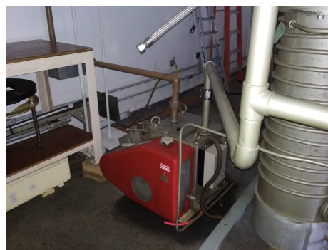
Figura 27: Bombas de vacío.
