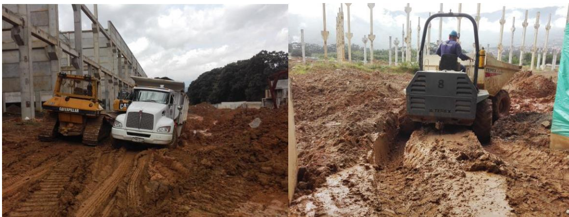
Imagen 18. Transporte de material con vías deterioradas
